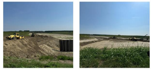
Realizzazione Impianto Idrivoro Cavaliera località Malcantone di Stellata - Comune di Bondeno (FE)
